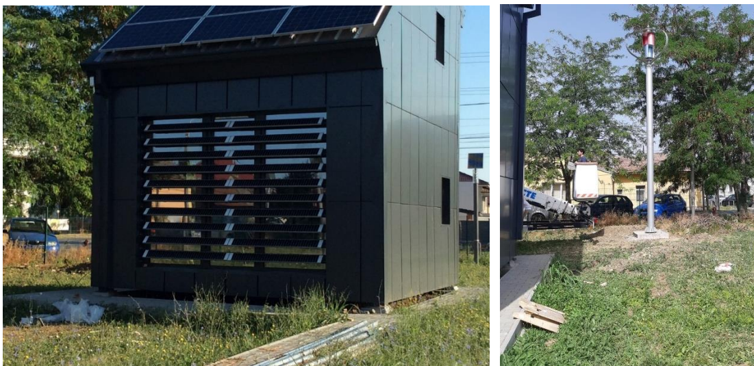
Fig. 1. Montajul lamelor fotovoltaice și a turbinei eoliene
